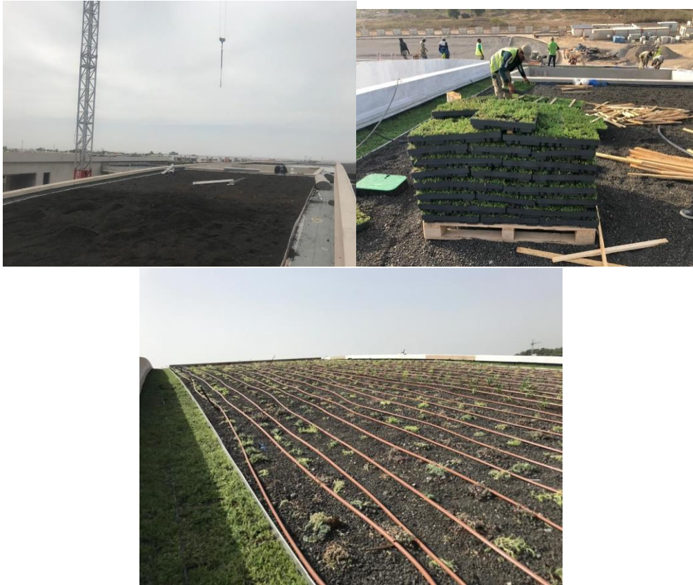
Figure 4: Travaux de pose du substrat et de la végétation pour la toiture végétalisée de l'Institut National Supérieur de Musique et des Arts Chorégraphiques Rabat – Maroc
