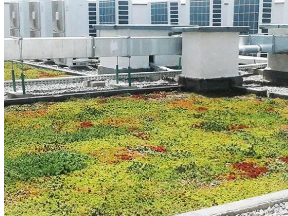
Figure 3: Toiture végétalisée sur un complexe immobilier collectif « Le clos d'Anfa » – Casablanca, Maroc
