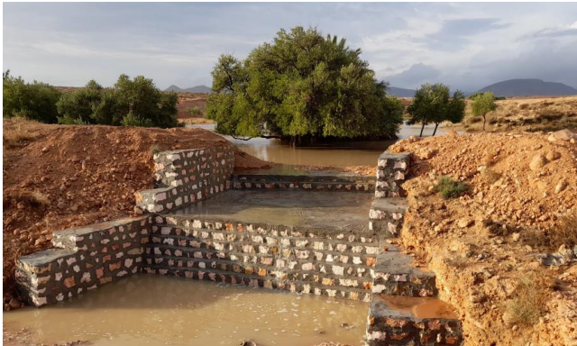
Figure 28 Ouvrage de recharge de la nappe à Gabès (Source CRDA de Gabès)
