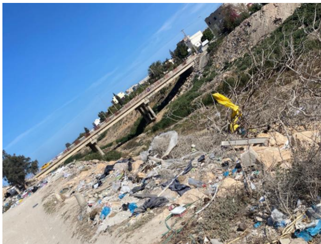
Canal de l'oued Gabès, Centre-ville, Lieu de rejets des déchets solides, 13 avril 2022
